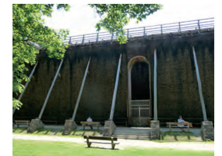
Gradierwerk (© RP Darmstadt)
