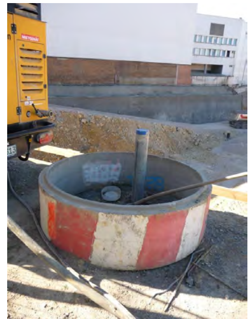
Abb.: Grundwassermessstelle; © RP Darmstadt
