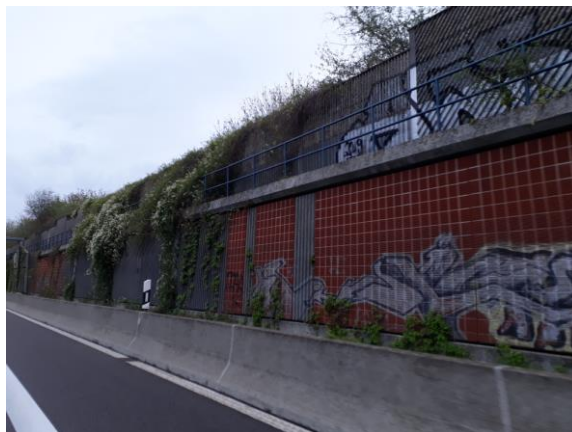
Abbildung 87: Lärmschutzwand an der B 45 im Bereich Weiskirchen © Regierungspräsidium Darmstadt
