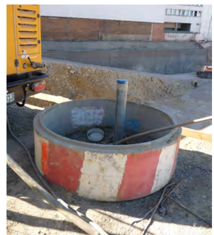
Abb.: Grundwassermessstelle; © RP Darmstadt
