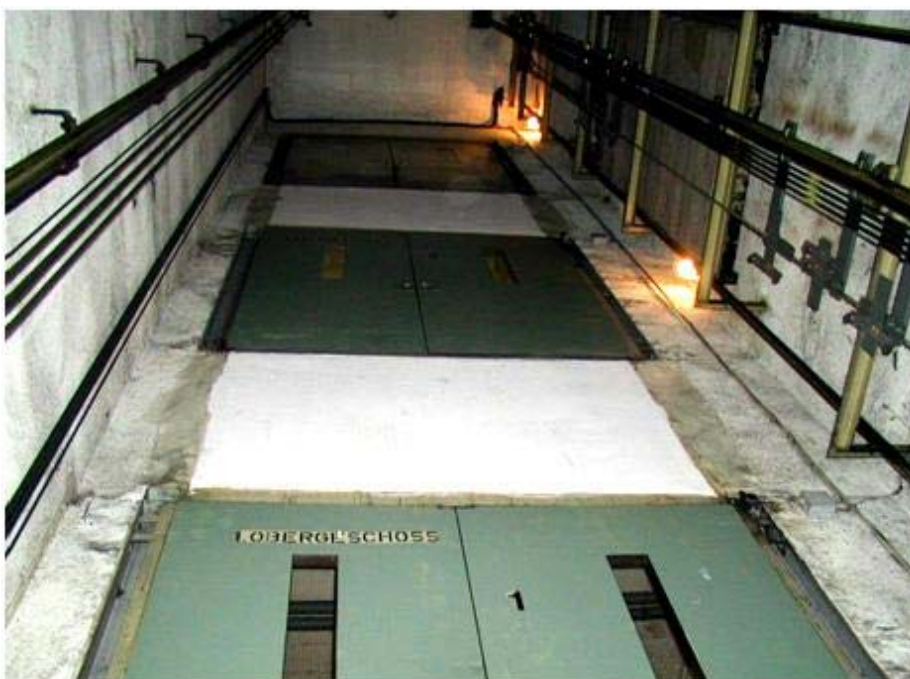
Abb. 2: Blick in den Fahrtschacht einer Aufzugsanlage - © RP Darmstadt
