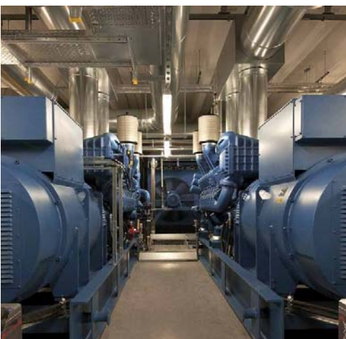
Abb. 3: Notstromaggregate für den Stromausfall (© Firma e-shelter)
