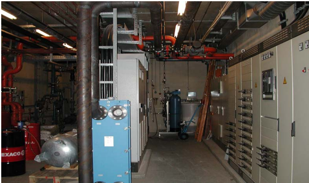
Abb.: Wärmetauscher (Mitte senkrecht stehend) zur Wärmerückgewinnung
