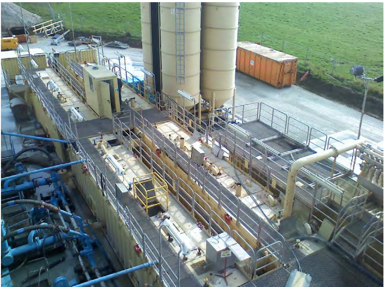
Bild: Betriebseinrichtungen und -anlagen eines Geothermie-Heizkraftwerkes (Sauerlach, Bayern)
