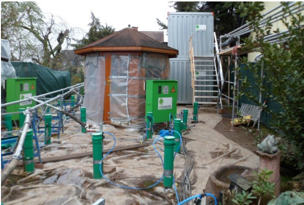
LHKW-Sanierung im Garten eines Wohnhauses, © RP Darmstadt Im Bild: Heizelemente (grün), Bodenluftabsaugung (graue Leitungen), Sanierungsanlage (graue Container).
